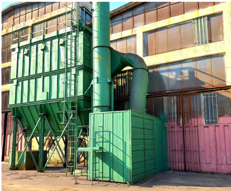
Fig.8 - opere di bonifica acustica relative al camino E14 (Barriera C del progetto di miglioramento acustico posizionata in accordo a quanto riportato in "Allegato T- Planimetria scarichi idrici aggiornata in fase esecutiva")
