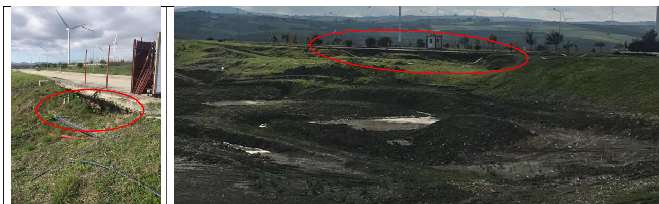
Fig. 2: Foto di alcuni smottamenti che hanno interessato le sponde per la parte superiore, coinvolgendo la fondazione della viabilità esistente
