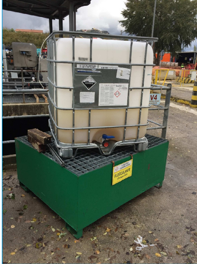
Figura 4 Esempificazione modalità di stoccaggio prodotti per trattamento acque e torri di raffreddamento
