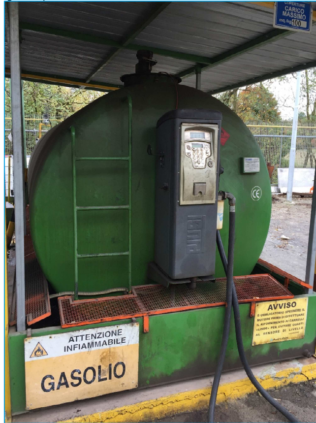
Figura 2 Serbatoio di gasolio per carrelli elevatori
