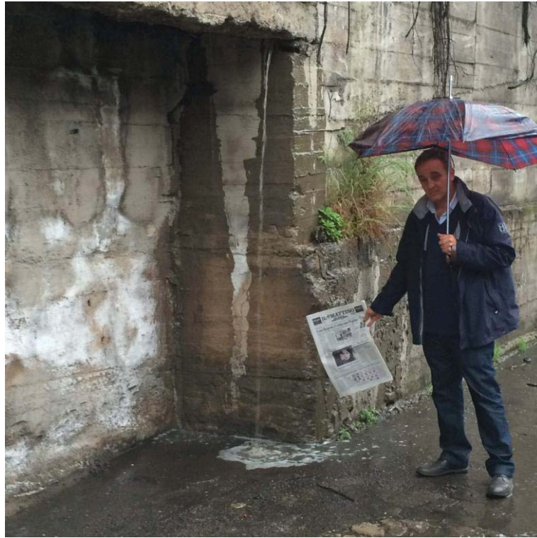
Muro di sostegno confine Est area aziendale Stato di fatto in occasione di evento pluviometrico
