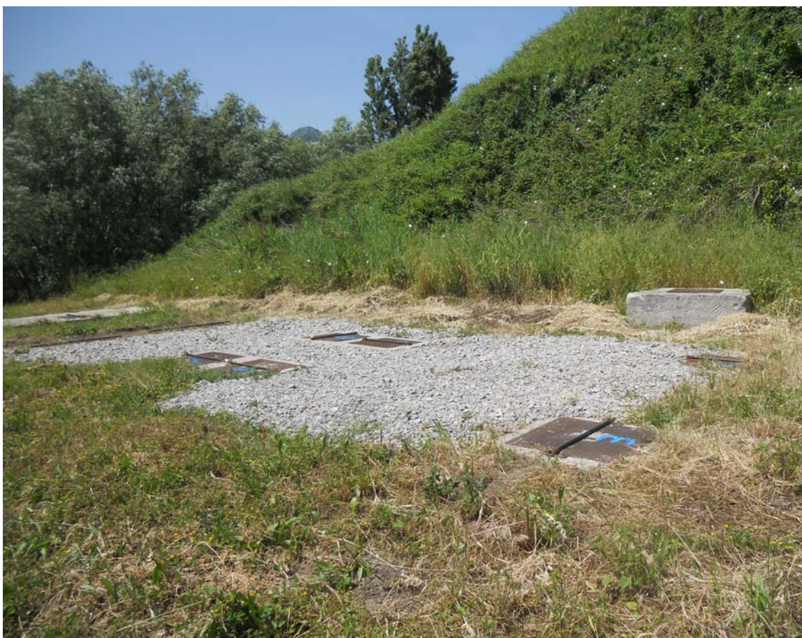
Figura 4.2 - Veduta di una parte dell'impianto di trattamento delle acque meteoriche esistente
