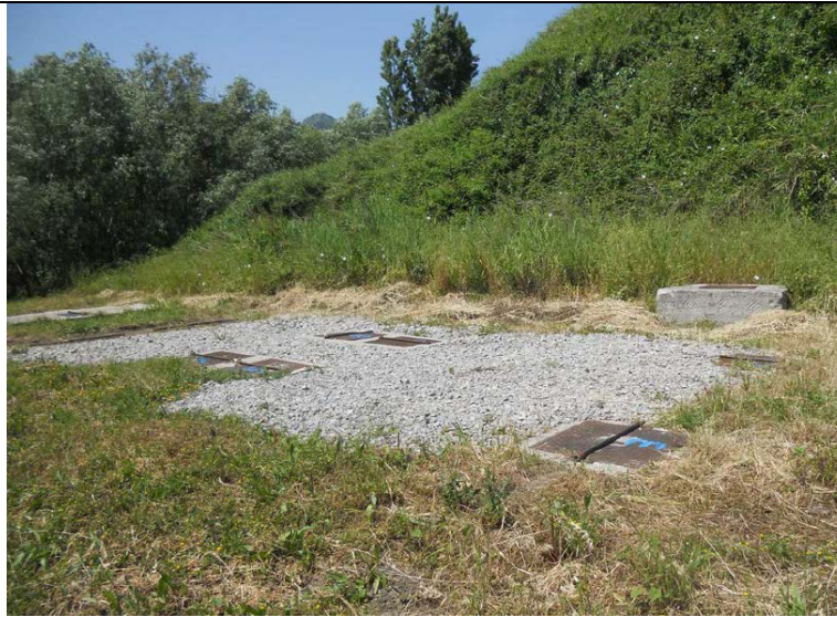
Veduta di una parte dell'impianto di trattamento delle acque meteoriche esistente
