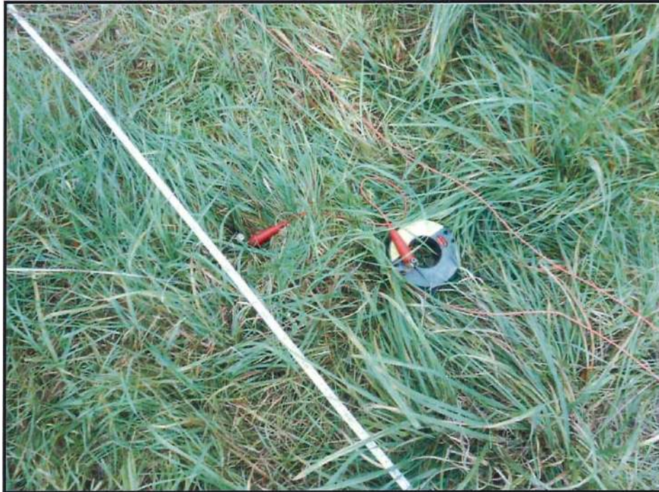
Fig. 6 – Elettrodo costituito da picchetto in acciaio inox infisso nel terreno.
