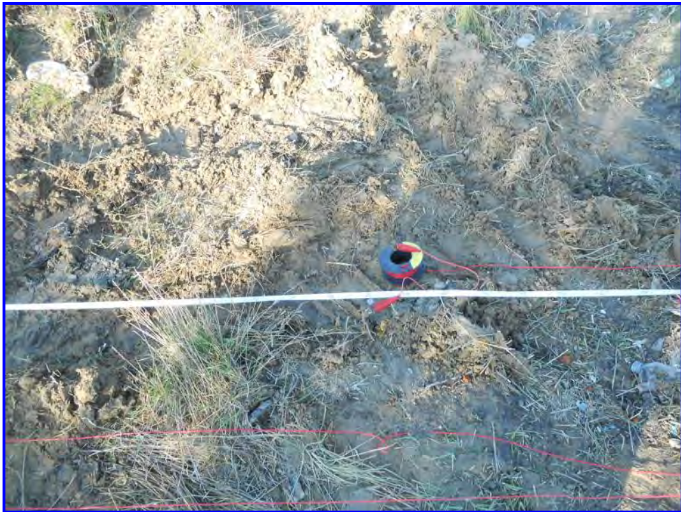
Fig. 6 – Elettrodo costituito da picchetto in acciaio inox infisso nella pavimentazione.
