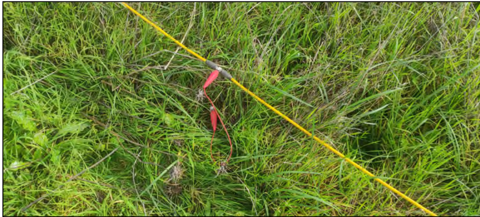
Fig. 5 – Elettrodo costituito da picchetto in acciaio inox infisso nel terreno.
