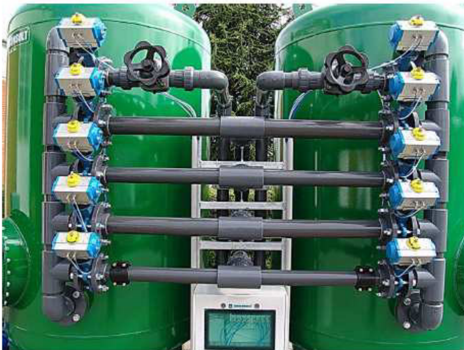
Vista quadro valvole
