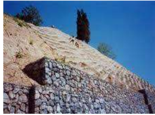
Gabbionate di contenimento
