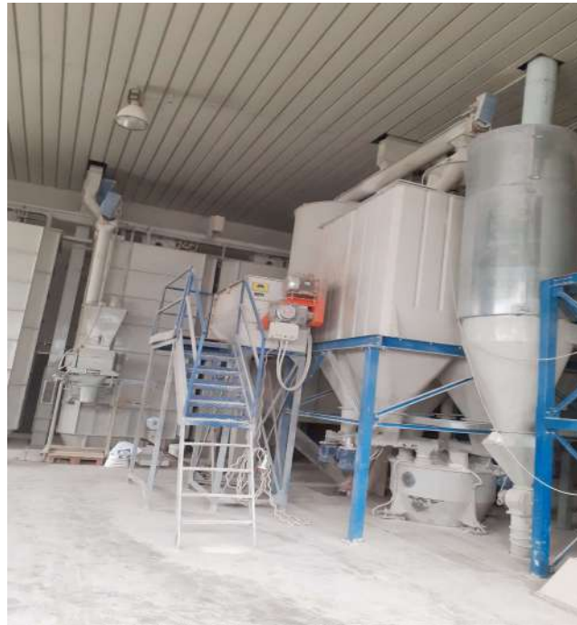
Foto 3 – Ciclone - filtro a maniche per l'abbattimento delle polveri
