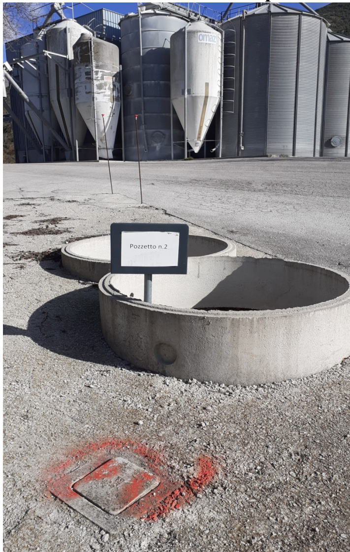
Foto 4 : pozzetto ispezione n. 2 scarico acque meteoriche
