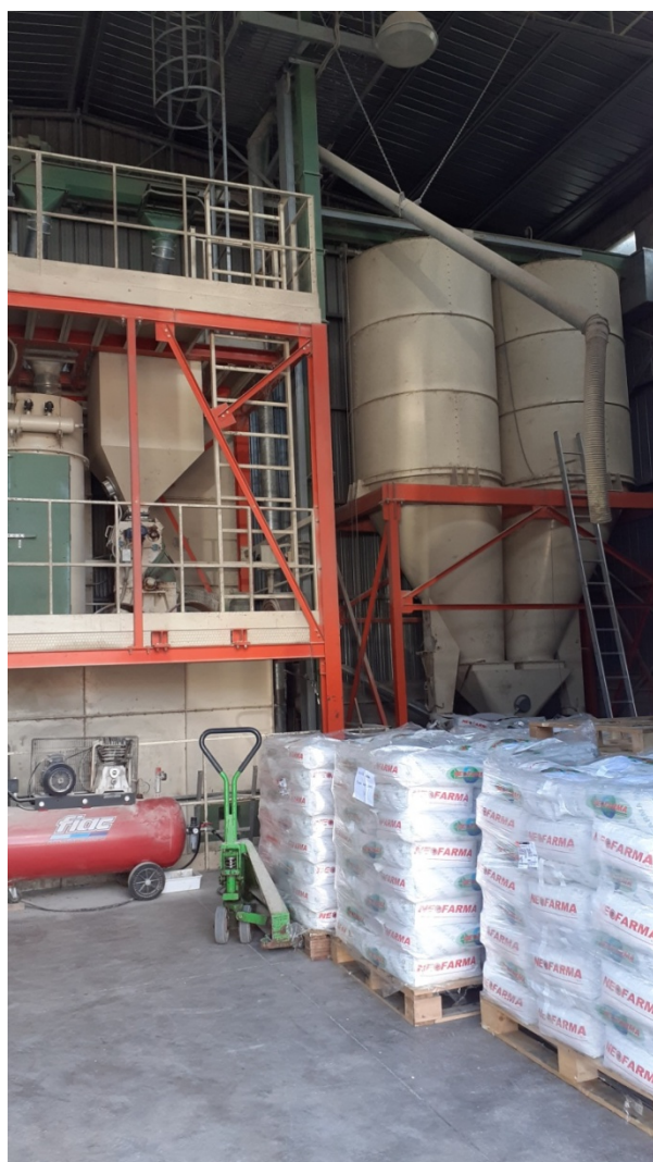
Foto 2 : impianto abbattimento a servizio del mangimificio
