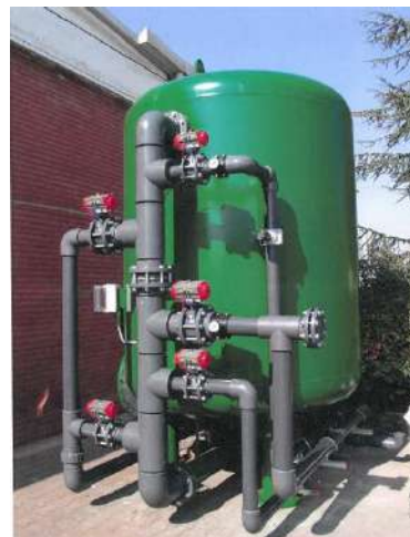
Esempio di filtro su skid
