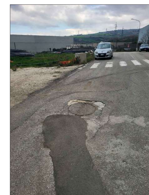
POZZETTO DI IMMISSIONE IN FOGNA ASI
