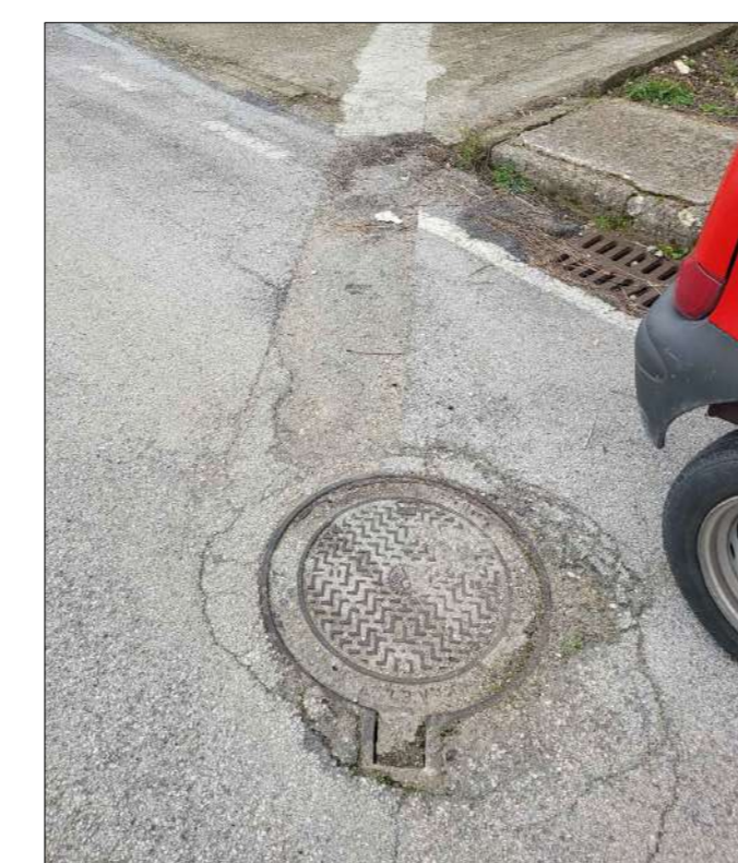
POZZETTO DI IMMISSIONE DELLE ACQUE DI PIAZZALE
