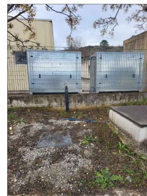
POZZETTO DI SCARICO/ISPEZIONE DELLE ACQUE INDUSTRIALI (PF)
