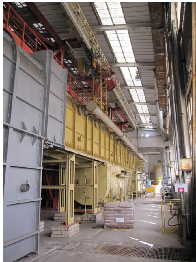
Figura B.3 – Vasche di trattamento impianto di decapaggio
